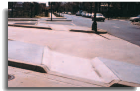
Rebaje de bordillo inadecuado. Las transiciones laterales son muy bruscas.
