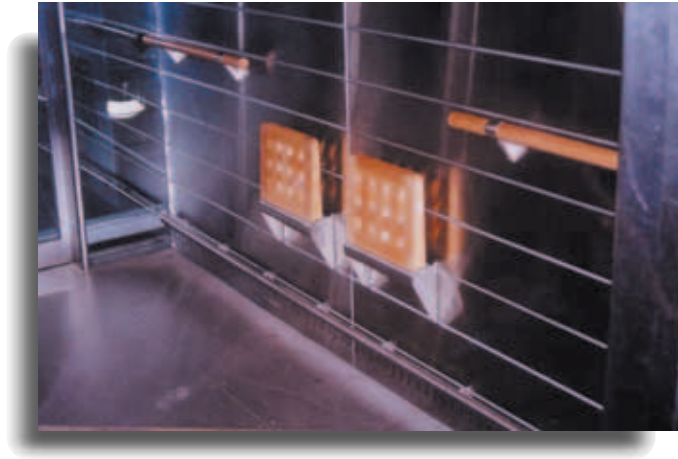
Detalle de asientos abatibles en un ascensor del aeropuerto de Oslo.
