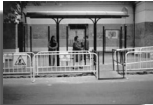
Solución de paso sobre zanja en una parada de autobús.
