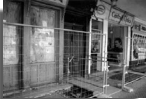
Vista de una mejor solución con pasarela y vallas de malla electrosoldada en lugar de cintas protegiendo la zona de trabajos.
