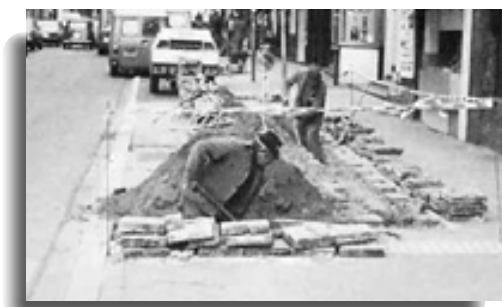
Protección inadecuada de obras.
