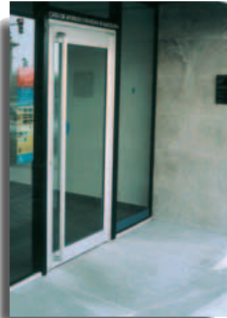
Fig. 17. Ejemplo de eliminación de escalón de entrada.
